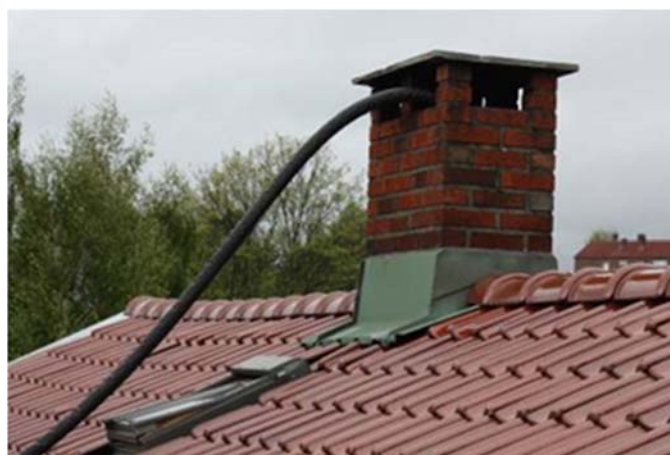
Figur 10. Rør fra solfangere som fører gjennom skorsteinen.
